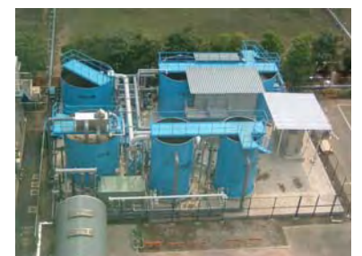
浄化プラント
